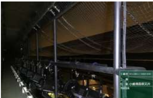
フェールセーフ設置状況（小劇場）
