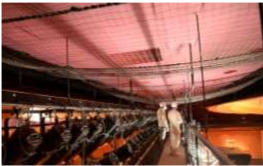
フェールセーフ設置状況（主劇場）
